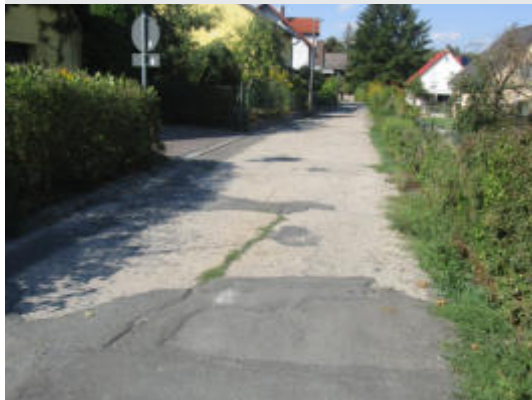
Sanierungsbedarf in der Malzstraße, Reichenberg
