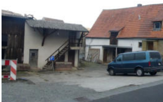
Gebäude mit hohem Sanierungsbedarf Am Haag, Reichenberg
